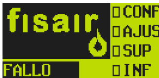
Estado inicial incorrecto
