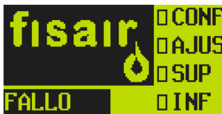
Estado inicial incorrecto
